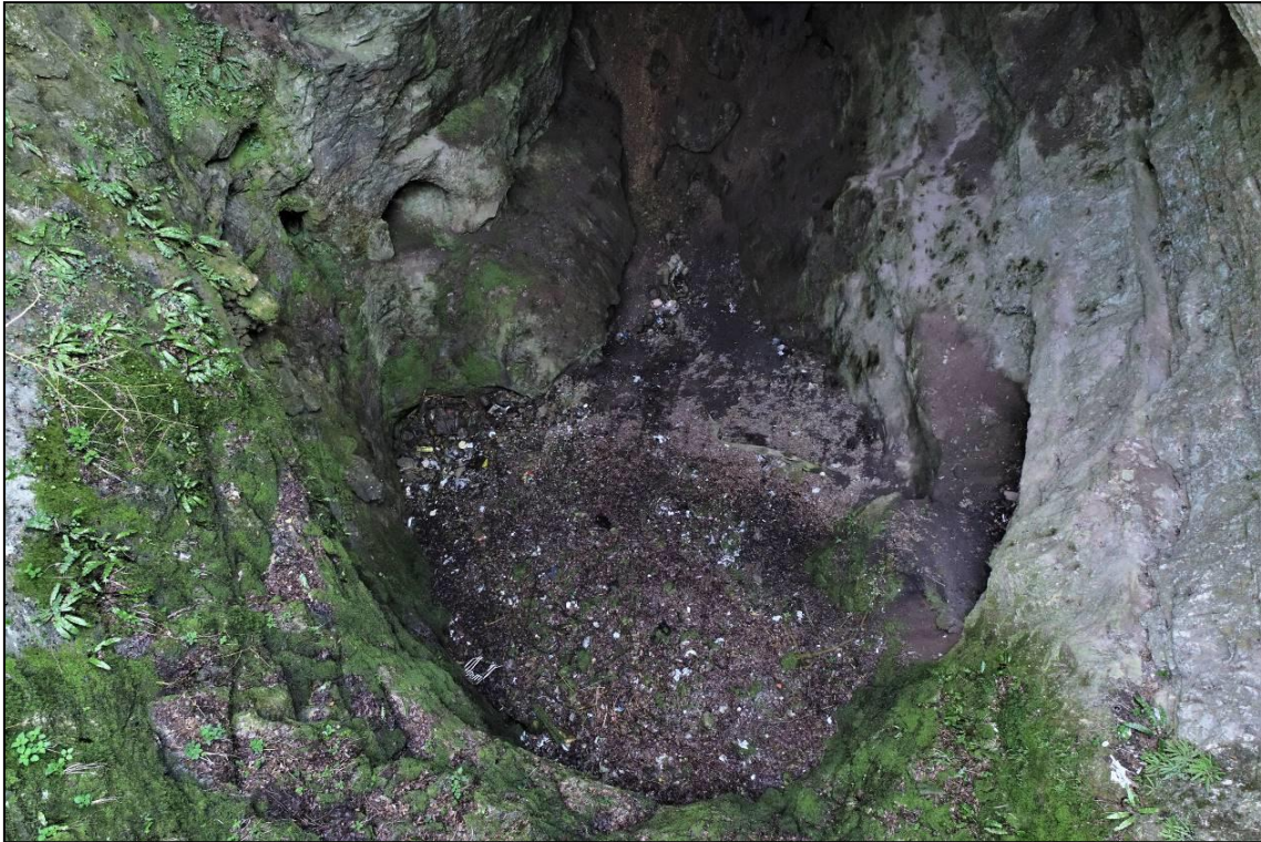
Slika 34: V Jamo v Bjekovniku (kat. št. 275), južno od Sežane, so v preteklosti odvrgli veliko odpadkov. Stanje še poslabšuje odtok odpadne vode s Sežanske čistilne naprave, ki so ga speljali v jamo in priteka skozi kraško podzemlje neposredno v tok podzemne Reke v Jami 1 v Kanjaducah (kat. št. 276) v t. i. »Sežanskem slapu« (fotografija: Jure Tičar, 7. 4. 2018).
